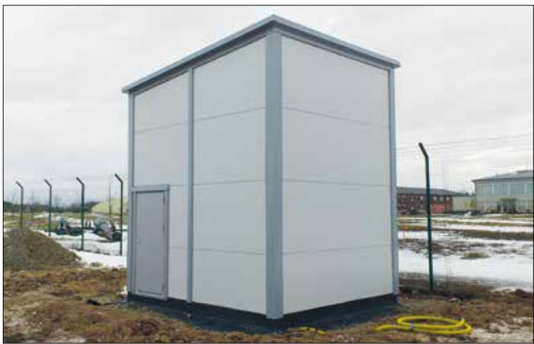
Trass on kogu pikkuses kõik maa all; ainuke rajatis, mis näha on, see on vahetult Kaitseväe 1. Jalaväebrigadi linnaku aia juures asuv liitumissõlme hoone.
