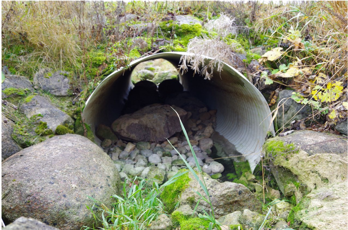
Foto 3. Allavoolu vaade kalapääsu truibile Joosepi talu tee all. Truubi paremas ääres on näha veerise alt paljandunud geotekstiili. Samaseid väikesi paljaks uhutud kohti leidub kalapääsus mitmeid.
